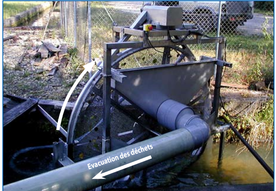
DÉGRILLEURS Ø2200 : Vue côté de l'arrivée d'eau (ci-dessus) Vue côté de la sortie d'eau (ci-dessous)
