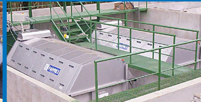
2 filtres 28-160 sur bâti en sortie de pisciculture
