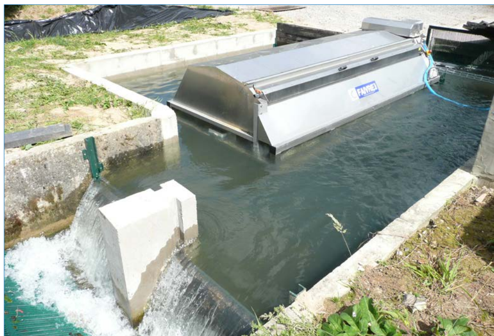
Filtere 32-160 sur bâti en sortie de site aquacole.
